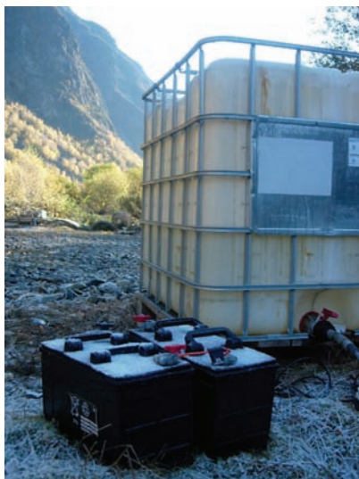
AIS-doseringsanlegg (1000 L) for sidebekker
