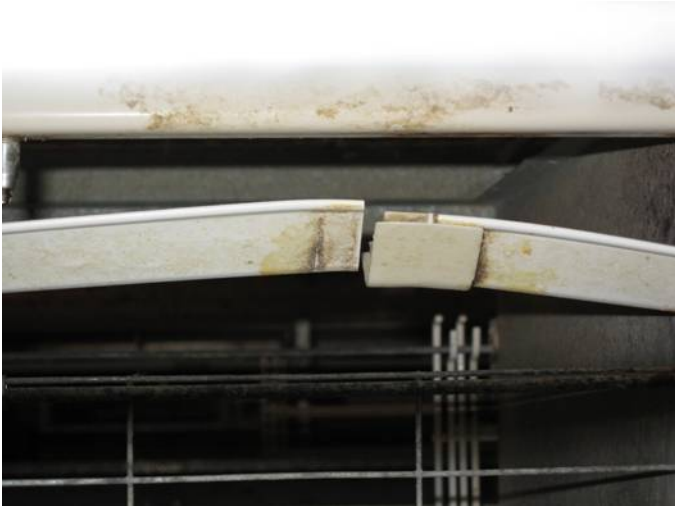
A. Deformasjon av spillvannsrenne
