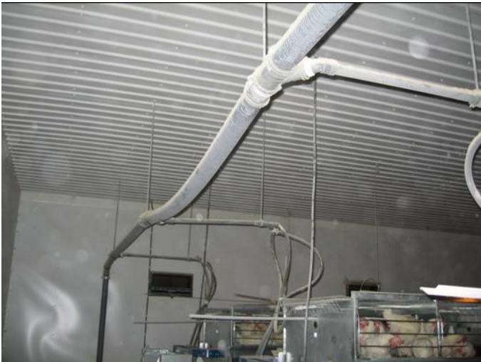
B. Deformasjon av rør for drikkevannstilførsel
